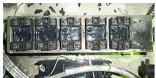
内部損傷確認
