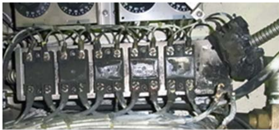
外観損傷確認
